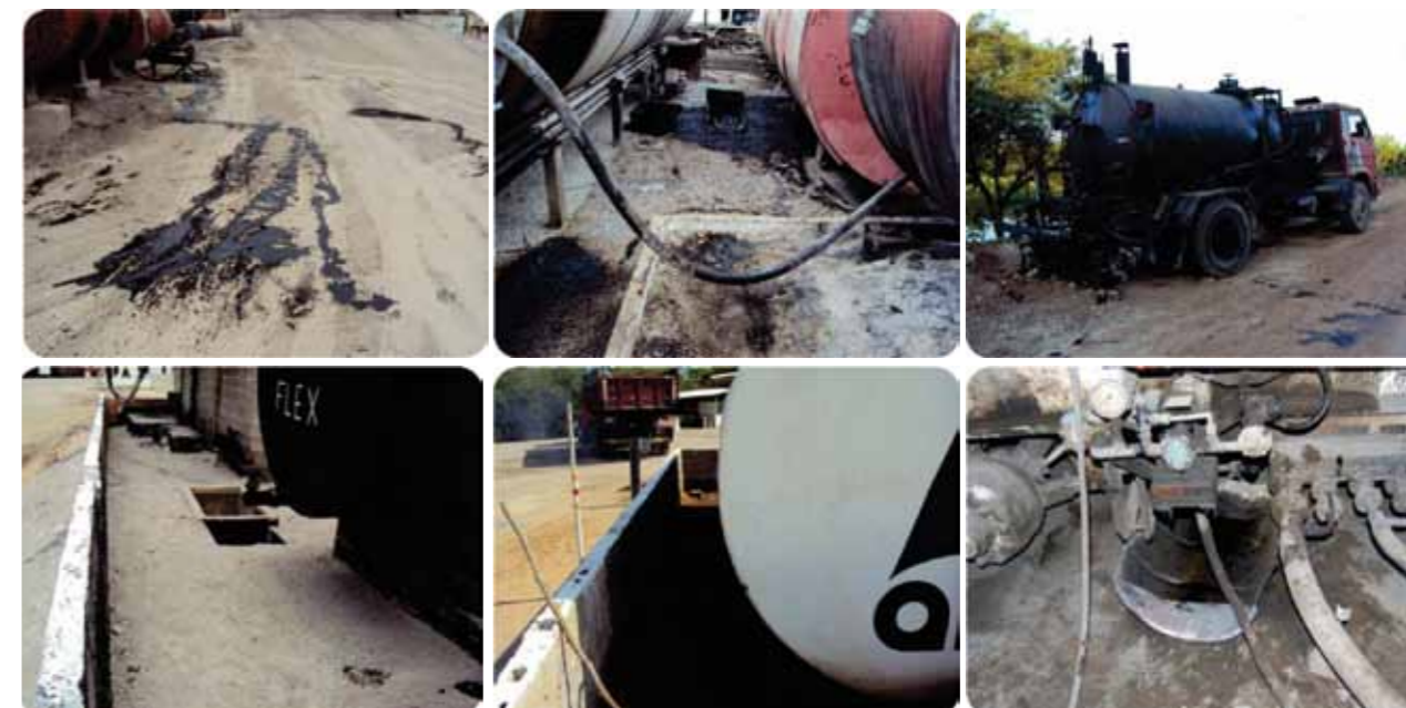
Figuras 31, 32 e 33 (acima) – Vazamento de óleo – Obras na BR-262/MS Figuras 34, 35 e 36 (abaixo) – Tanques de asfalto e reservatório de combustível sem vazamento – Obra na BR-262/MS
