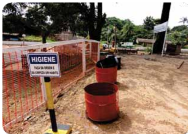
Figura 14 – Acondicionamento temporário de resíduos no canteiro de obras da ponte sobre o Rio Madeira – BR-319/RO.
