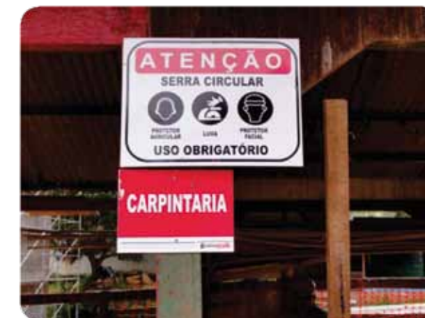
Figura 16 – Sinalização de prevenção de acidentes no canteiro de obras da ponte sobre o Rio Madeira – BR-319/RO.
