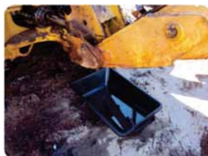
Figuras 29 e 30 Medidas de contenção de vazamento de equipamentos (bandejas de contenção) – Obras na BR-262/MS/SP – Ponte sobre o Rio Paraná.
