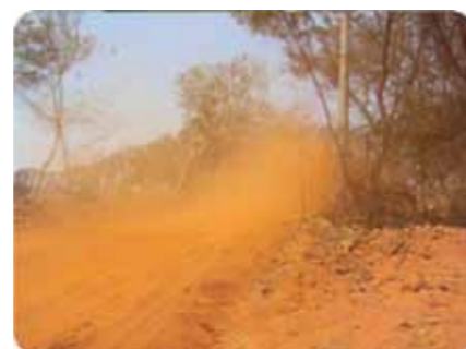
Figuras 46 e 47 – Processo de umectação da via – Obras na BR-262/MS/SP – Ponte sobre o Rio Paraná.
